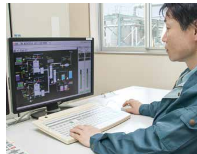
リサイクル計装室 / Recycling Instrument Room
