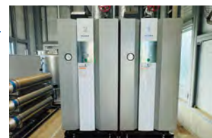
省エネ型ボイラー
